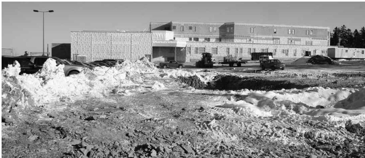
Les travaux vont bon train au Centre communautaire Sainte-Anne à un point tel que l'école et la garderie devraient ouvrir leurs portes en septembre prochain.
